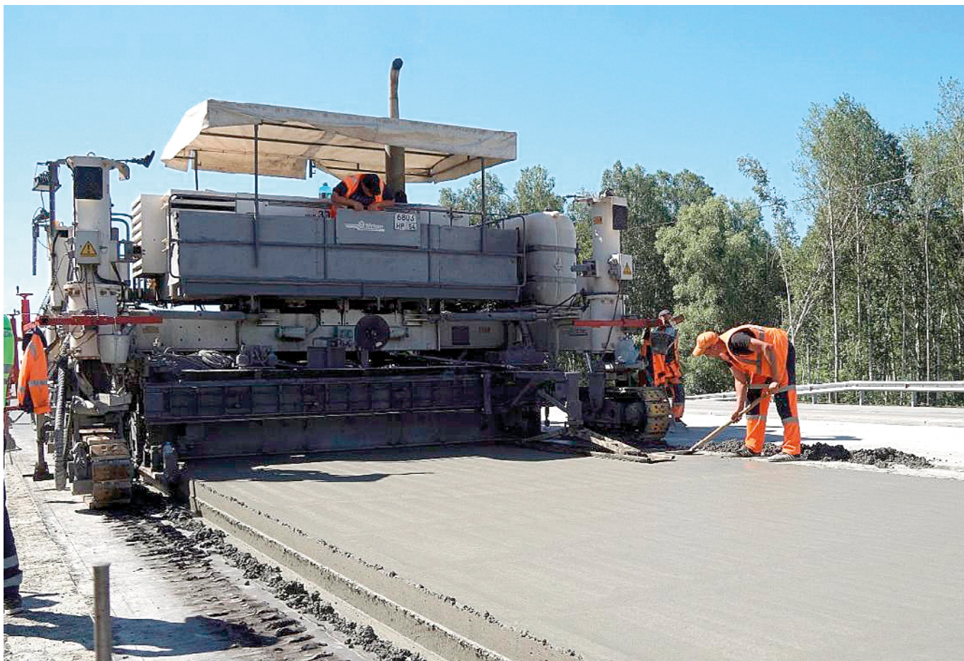
Новосибирскавтодор. Реконструкция и строительство дороги Р-254 (М-51 «Байкал»). Одна из немногих в России дорожных строек, где применяется цементобетон
